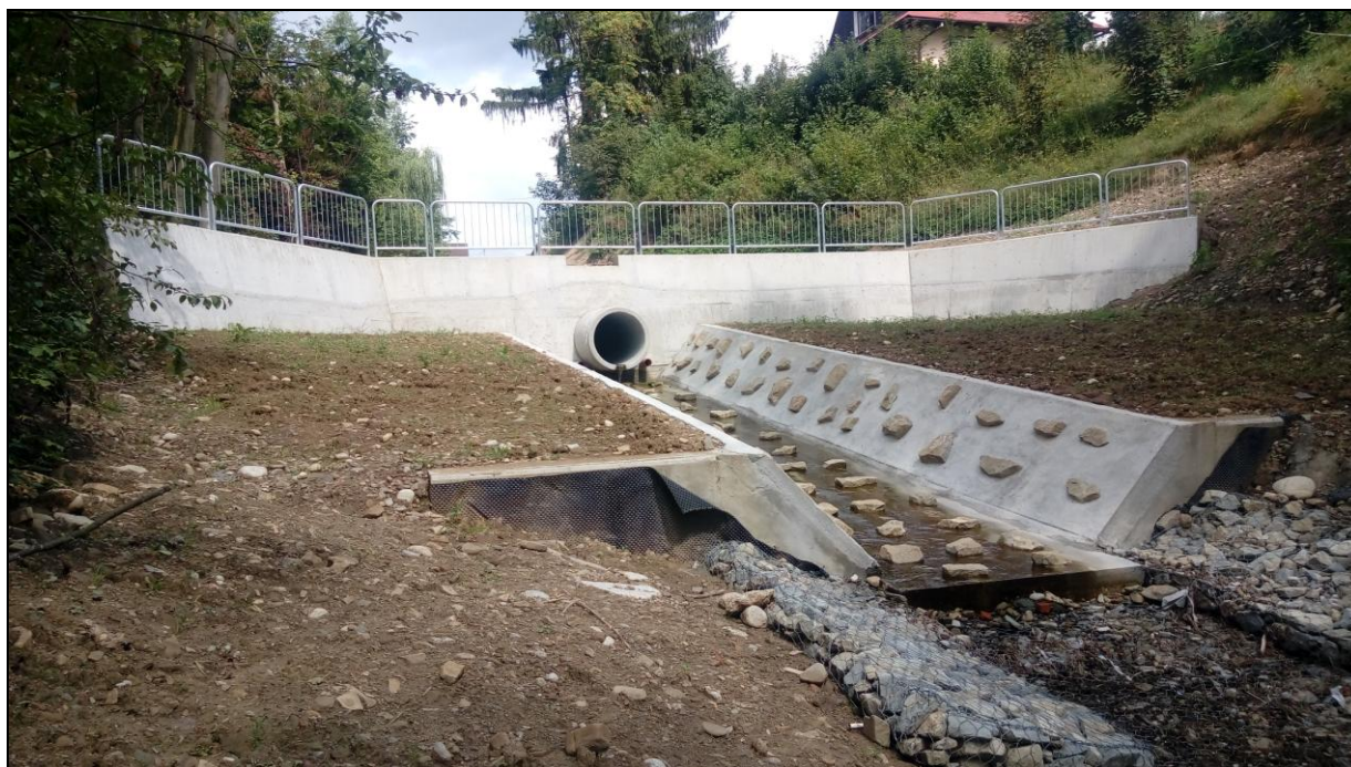
Zmodernizowana kanalizacja deszczowa
