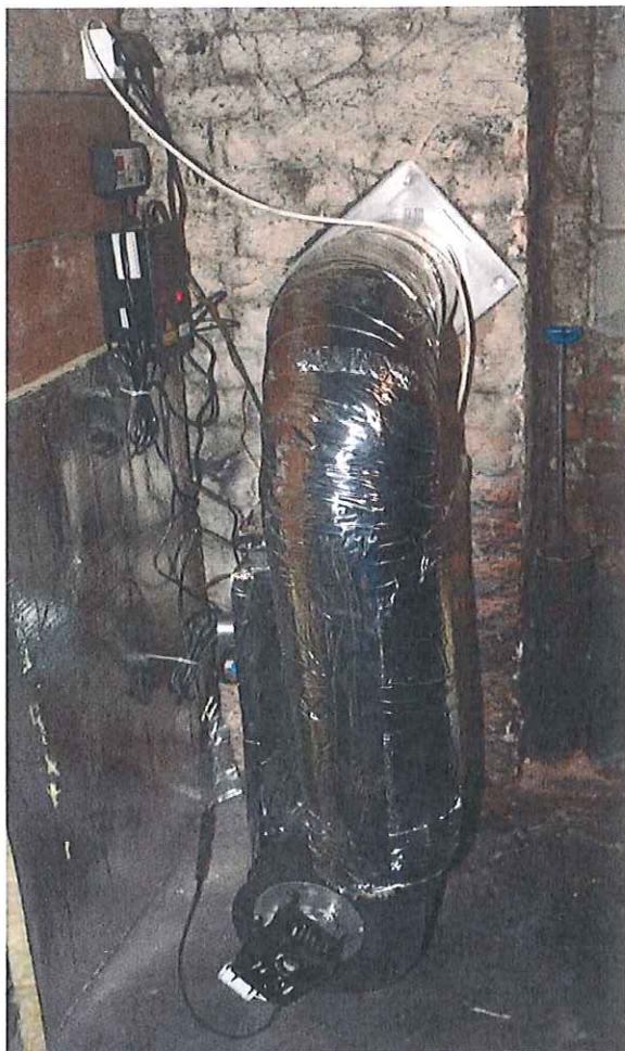
„Zainstalowany Elektrofiltr” Źródło Wydział Gospodarki Komunalnej i Ochrony Środowiska
