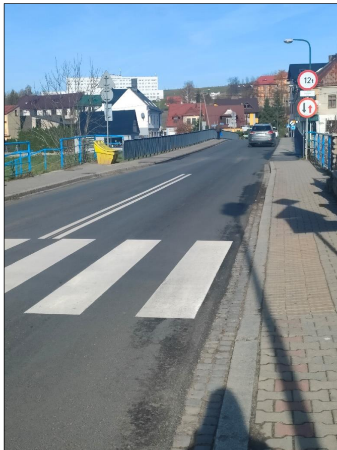
Most w ciągu drogi gminnej ul. Kościuszki po wykonaniu prac konserwacyjno – naprawczych
